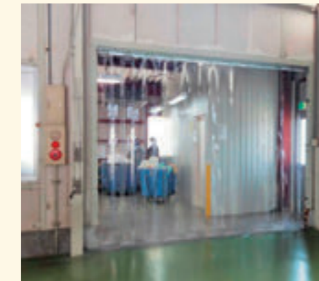
保温・保冷 防塵 のれんシート、のれんシートフレーム使用
